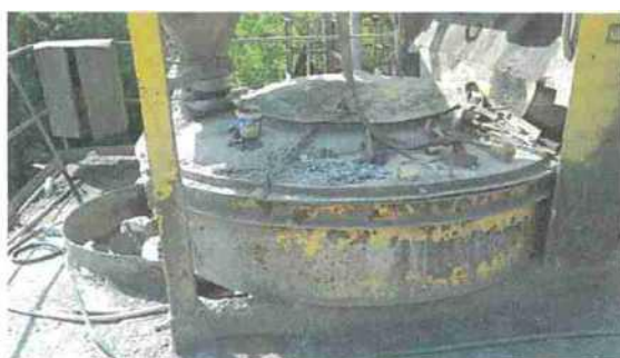
Fot. 4-węzeł betoniarski ZREMB B303
