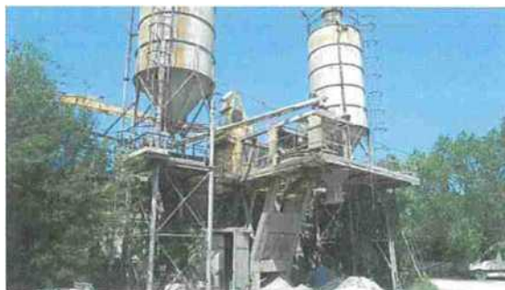
Fot. 2-węzeł betoniarski ZREMB B303
